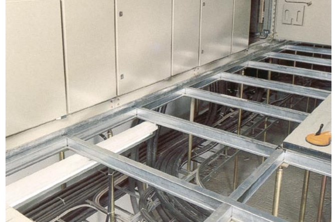
Keskus- ja valvomotilojen erikoisasennuslattia
