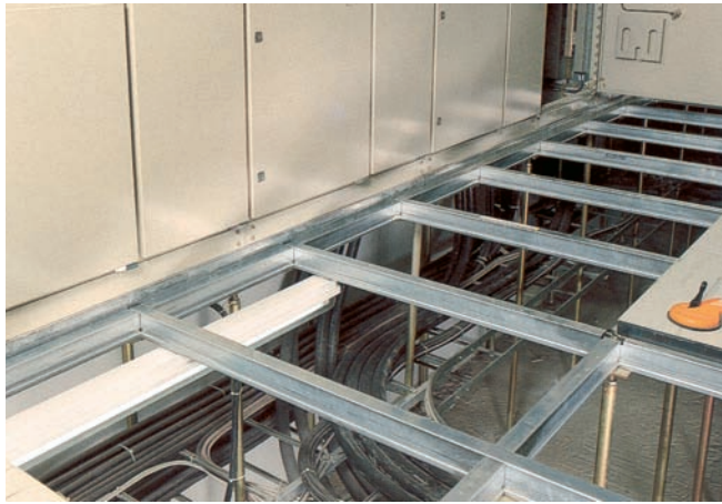
Keskus- ja valvomotiilojen erikoisasennuslattia.
